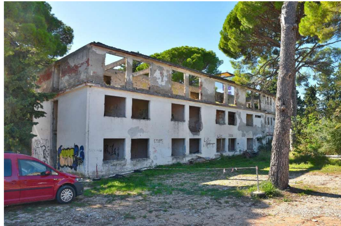
Sl. 56. Derutna zgrada nekadašnjeg odmarališta Fruške gore
